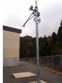
【積雪観測設備】
