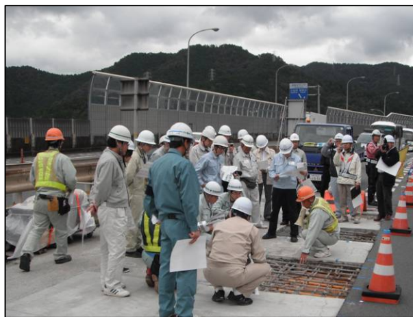
劣化した床版を取り除いて、新しくコンクリートを打ち直す作業（床版打換）
