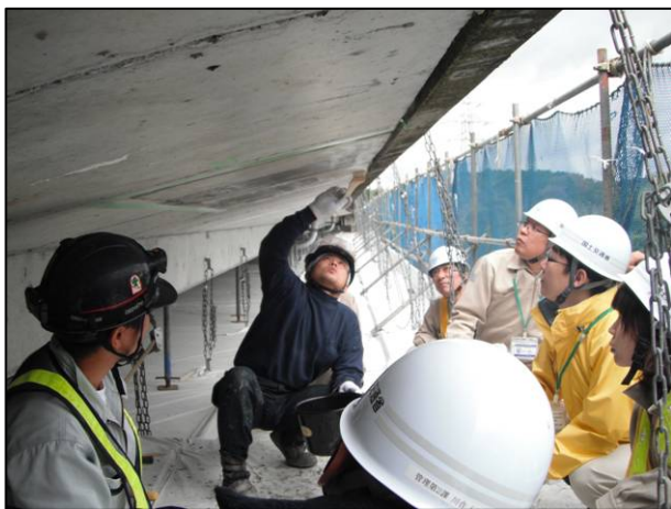
塩害によりコンクリートが劣化している箇所の修復作業状況（断面修復）
