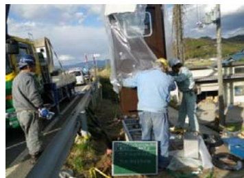
▲国道8号他散水融雪設備他修繕工事 施工者:(株)柿本商会 福井支店
