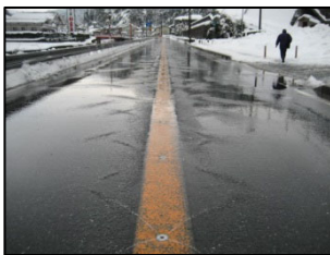
散水融雪設備
