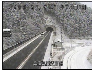
無散水融雪設備
