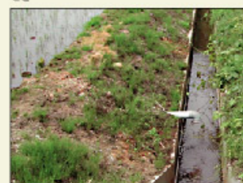
排水パイプによる水田と水路の分断
