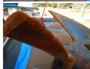
撤去したインペラ(欠損・腐食が進行していた)
