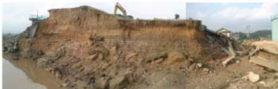
破堤断面(下流側断面)
