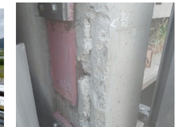
コンクリートの欠損、鉄筋の露出腐食を発見
