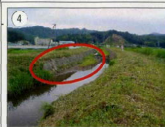
下ノ宮川はコンクリート護岸が続いており、現状では生物の生息に適した状態ではないため、今後検討が必要である。
