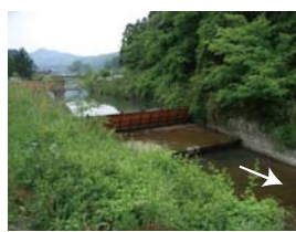
水叩、馬場堰 (273-3) (堰が起立している時は不連続となる ほか、水叩部の落差が大きい)
