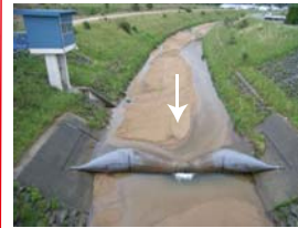
ゴム堰 (264-3) 砂が堆積し、変形している 流量は非常に少ない
