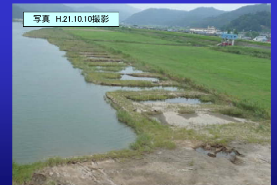
H21.8の出水により仕切堤等が洗掘
