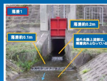
樋門直下の落差
