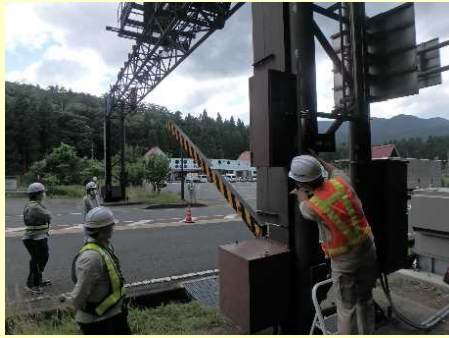
電動操作盤による遮断機の操作
