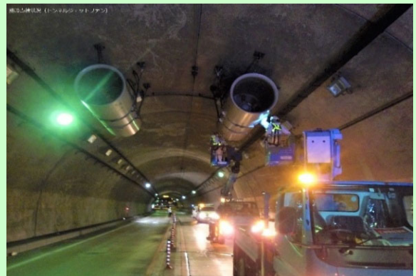
トンネル換気設備点検
