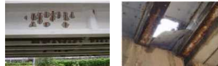
コンクリートの保護塗装後に剥離した例 鋼板接着により補強されたコンクリート床版が抜け落ちた例
