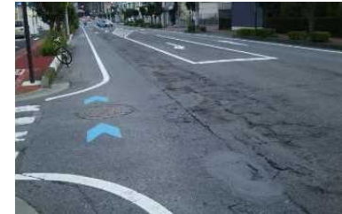
占用工事が起因する路面損傷
