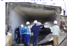
熊本地震における地方公共団体管理施設の被害状況調査
