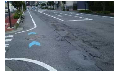
占用工事が起因する路面損傷
