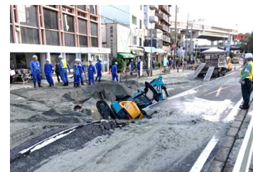
埋設管の老朽化に伴う道路陥没
