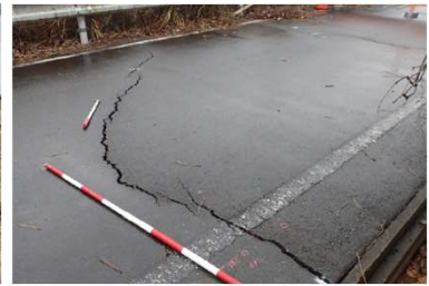
市道路面クラック
