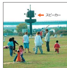
放流警報設備
