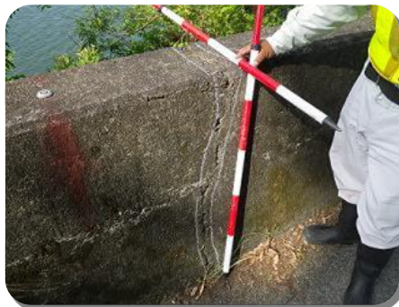
▲特殊堤の損傷を発見
