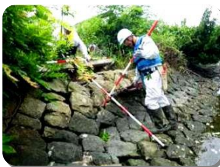
▲護岸の変形を発見
