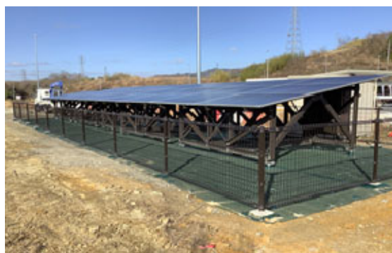
太陽光発電装置外観
