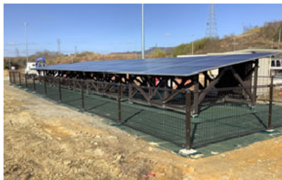
太陽光発電装置外観
