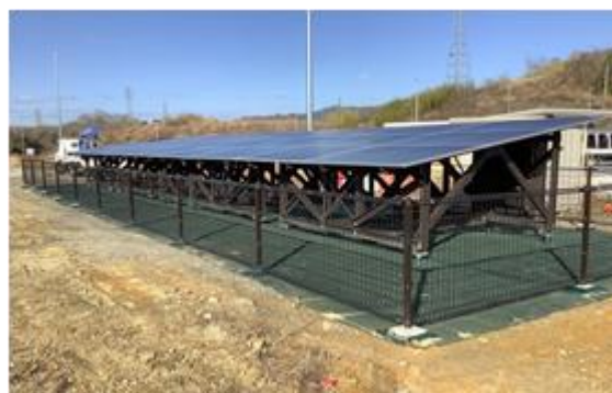
太陽光発電装置外観
