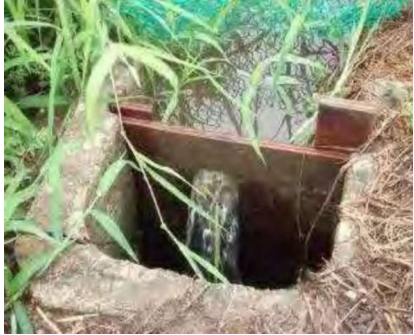
田原本町 水田貯留のオリフィス設置 (水田貯留)
