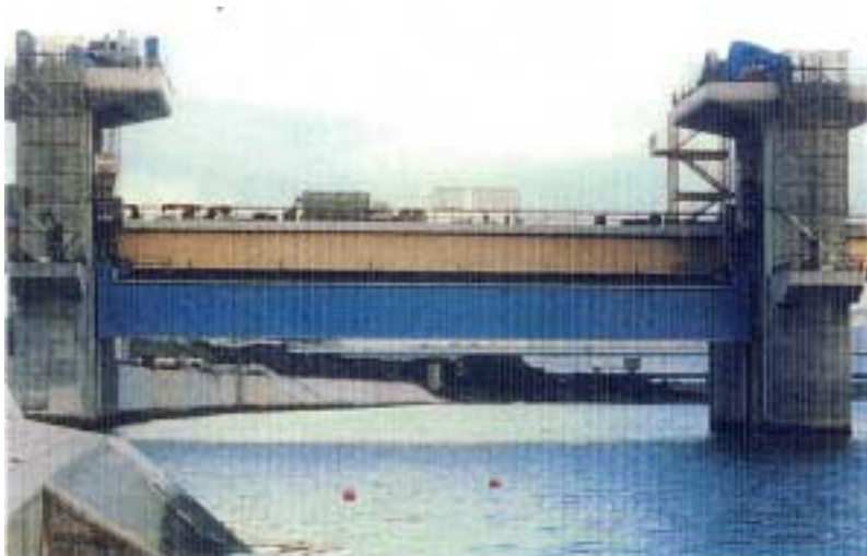
開閉装置を使用して扉体を引き、上げ台船を撤去させた状況
