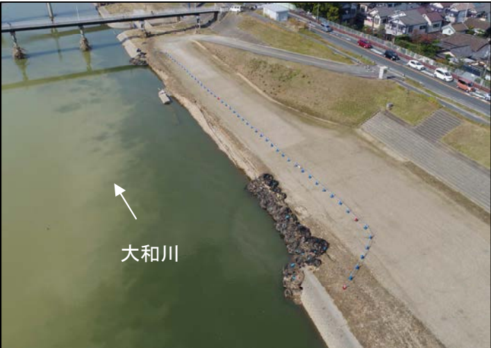
大和川右岸1.8k 低水護岸損壊 L=115m
