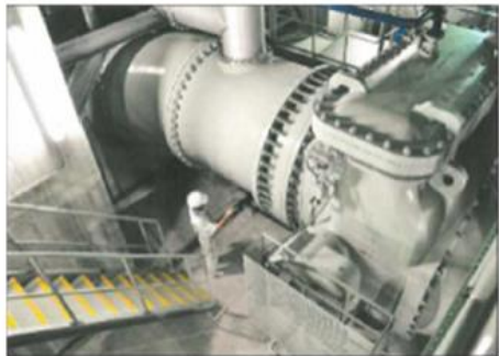
雨水ポンプの整備
