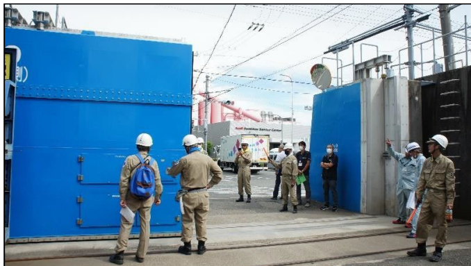
西成区 鉄扉開閉操作①
