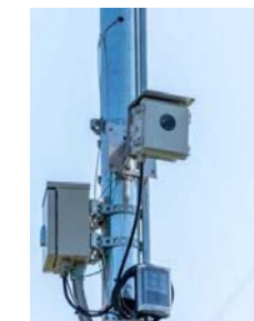
簡易型河川監視カメラ(設置例)
