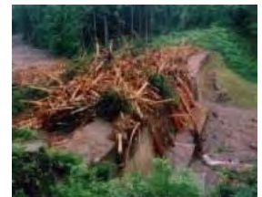
流木捕捉式治山ダム
