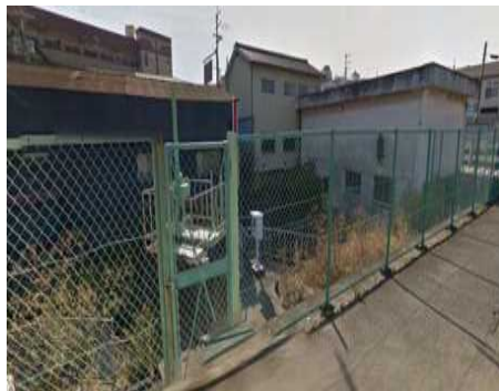
国分第1雨水ポンプ場
