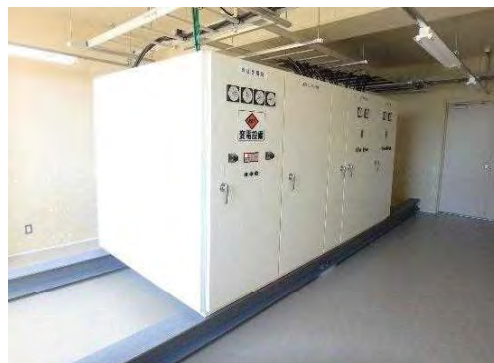
移設後の受変電設備
