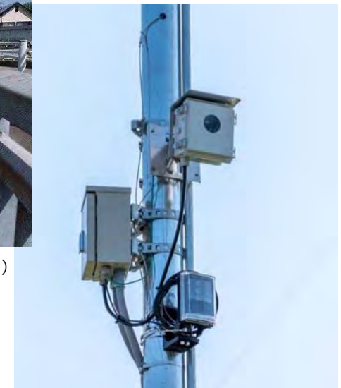
簡易型河川監視カメラ（設置例）
