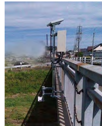
危機管理型水位計（超音波式） （設置例）
