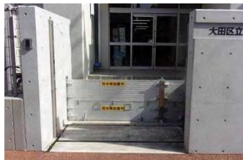
通用門に設置した止水板
