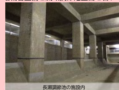
長瀬調節池の施設内
