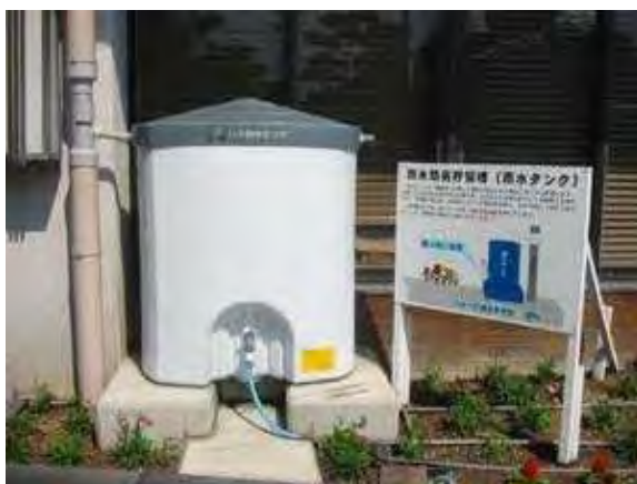
雨水タンク設置状況(市役所前)
