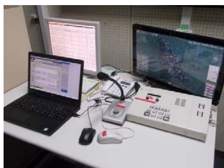
防災行政無線 親局設備
