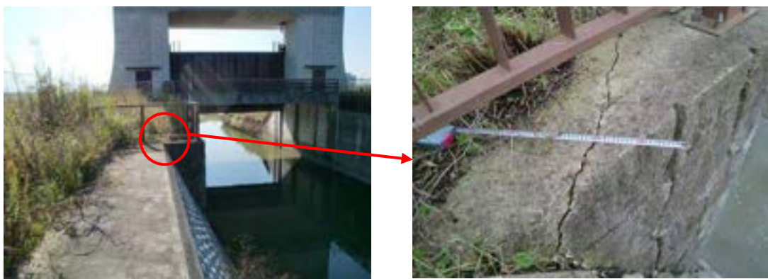
(呑口部擁壁のクラック)
