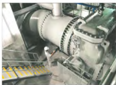
雨水ポンプの整備
