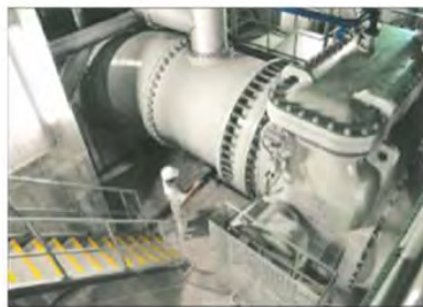
雨水ポンプの整備
