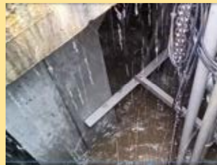
【田原本町 社会福祉協議会雨水貯留施設】 約5000m³を貯留し、周辺の浸水被害を回避
