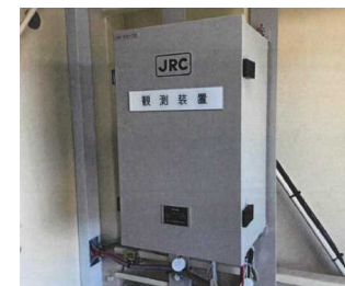
IPテレメータ観測装置設置
