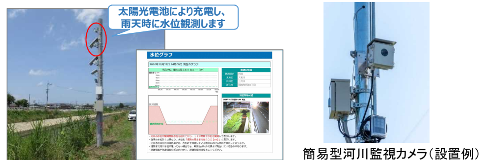
危機管理型水位計(設置例)
