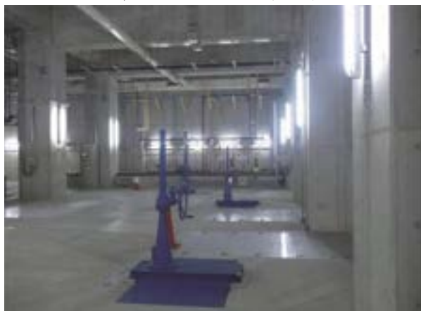
地下の下水処理施設
