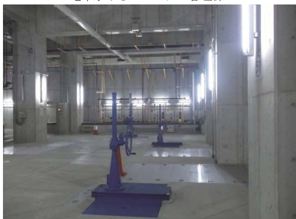
地下の下水処理施設
