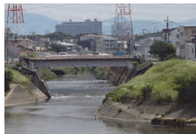
捷水路 対岸から2022年 ラバーダムがしぼんでいる
