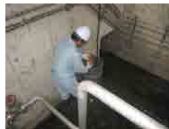
惣持寺樋門浄化施設の設備点検
