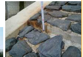
(護岸の沈下 川表部)
