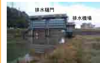
排水機場の事例
