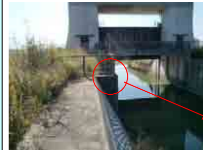
<モニタリング調査による変状確認>
