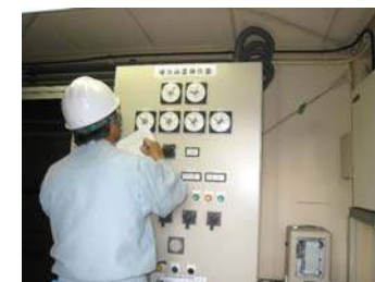
神南樋門浄化施設の設備点検
