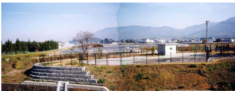
写真 2.8 三輪川浄化施設
