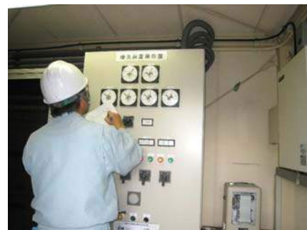
写真4.13 神南樋門浄化施設の設備点検
