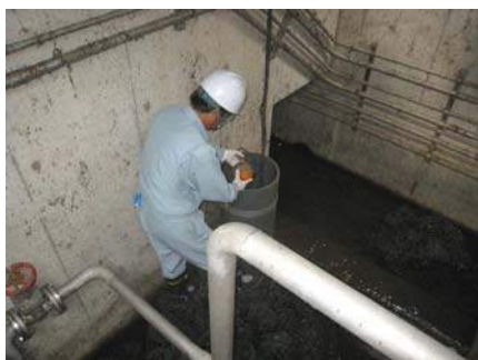
写真4.12 惣持寺樋門浄化施設の設備点検
