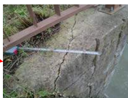
(呑口部擁壁のクラック)
