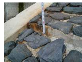
(護岸の沈下 川表部)
