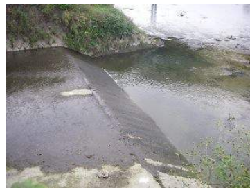
写真2.2 樋門樋管合流部の落差
