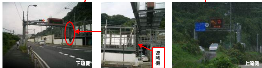
図 4.32 通行規制設備
