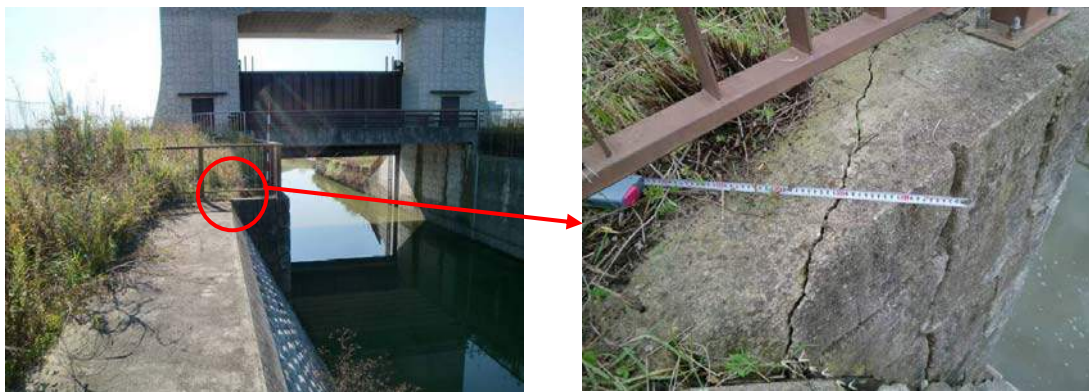
(呑口部擁壁のクラック)
