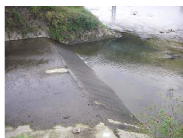
写真2.2 樋門樋管合流部の落差 (不毛田樋門、大和川33.2k左岸)
