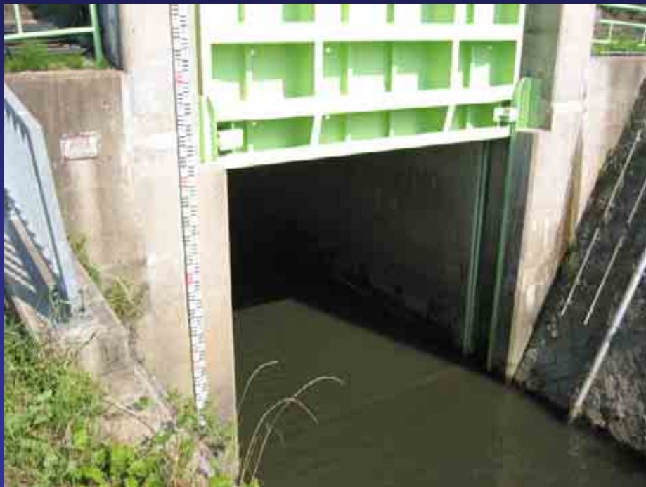
樋門は開いた状態です。
