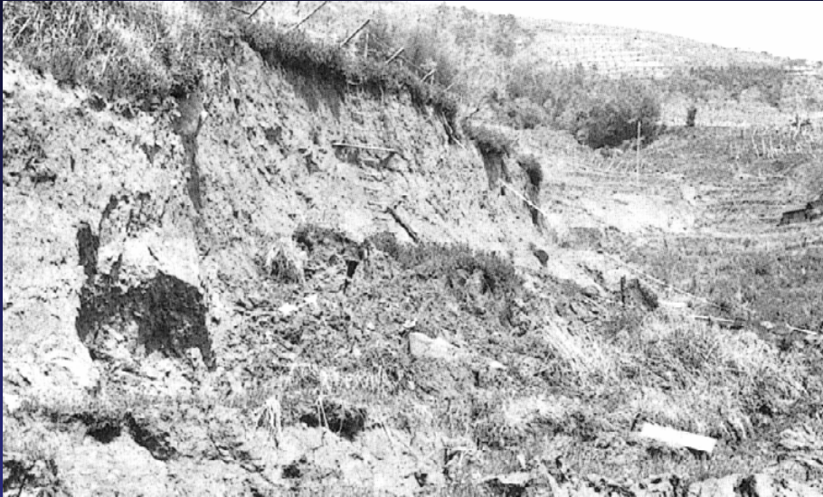
昭和42年2月 清水谷上流の亀裂
