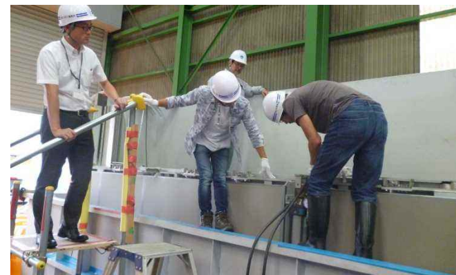
油圧ホース接続
