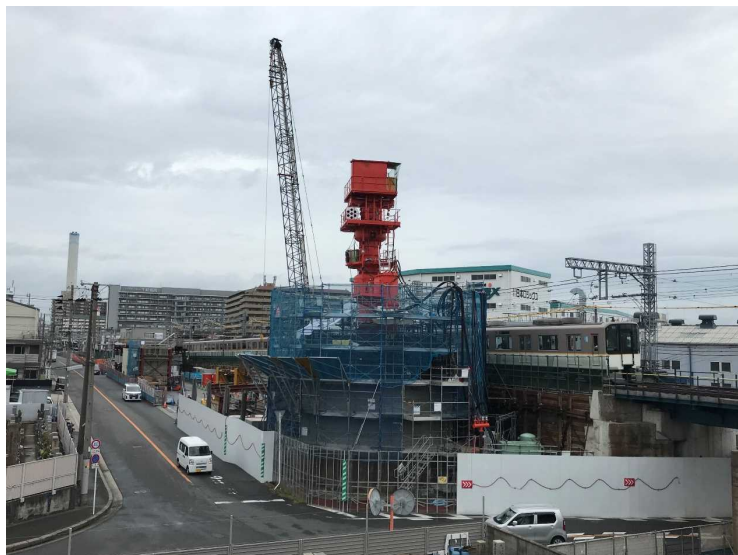
① P46ニューマチックケーソン基礎工（9R鉄筋組立）
