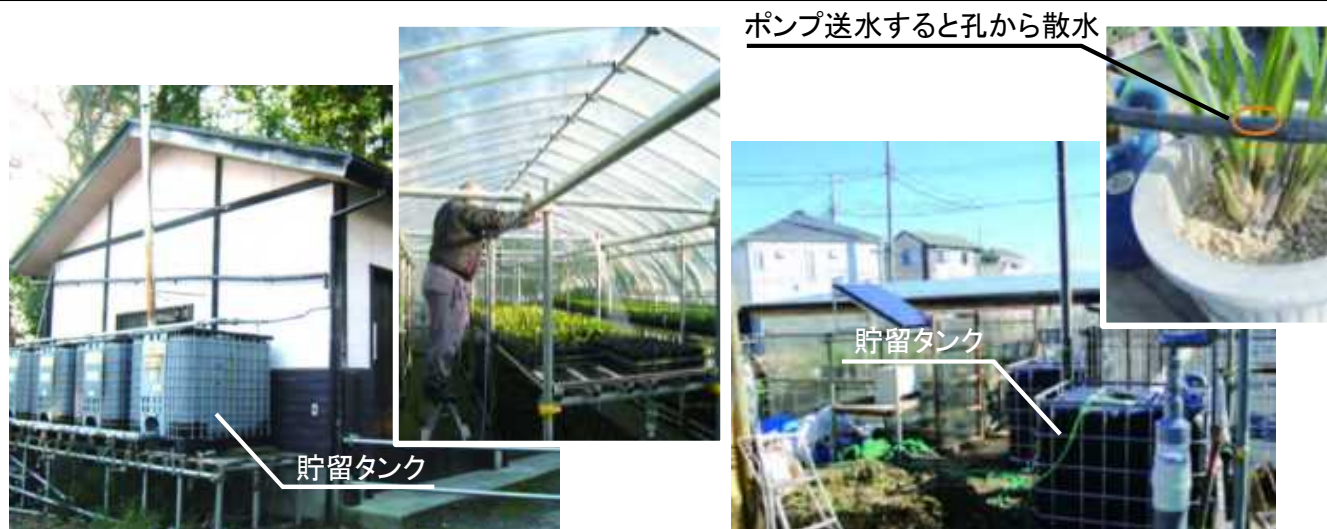
雨水活用施設
