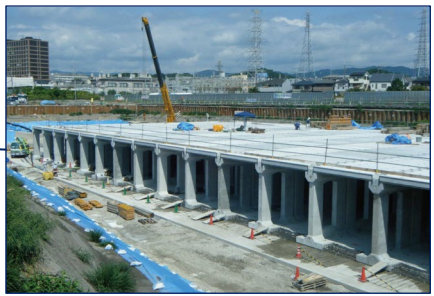
雨水貯留施設(安満遺跡公園)
