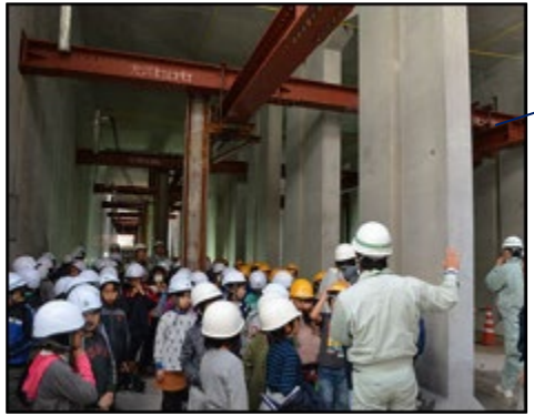
雨水貯留施設(高槻城公園)
